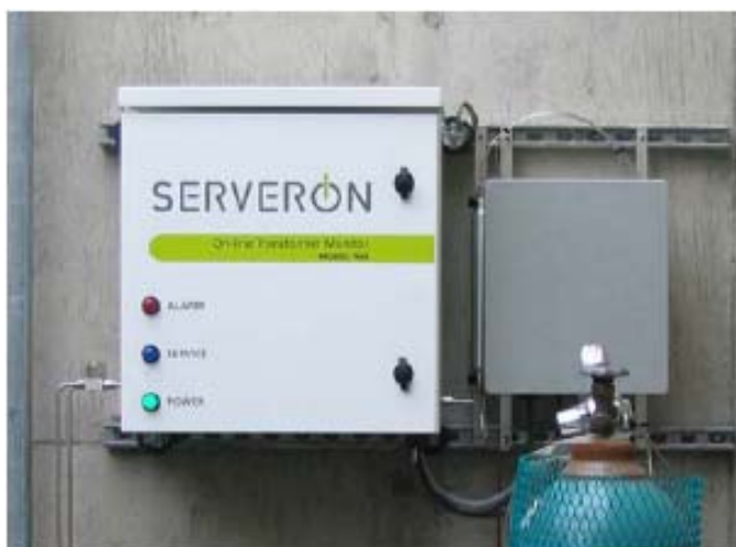
图 6 监测仪墙壁安装
