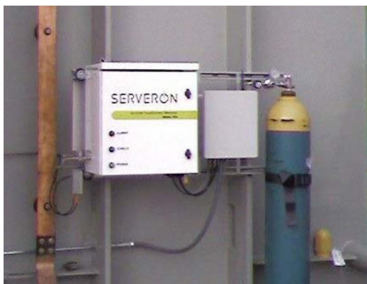
图 7 监测仪变压器箱壁安装
